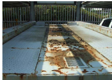
図 4-2-14 立体駐車場の腐食
