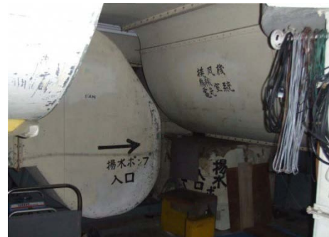
図 4-2-12 老朽化する空調関連設備
