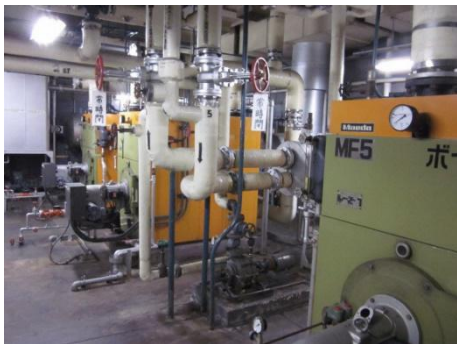
図 4-2-11 更新時期を迎える熱源設備
