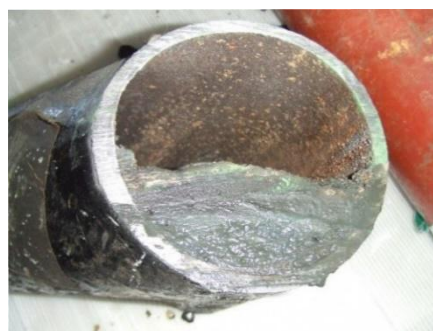
図 4-2-8 堆積物による排水管詰まり
