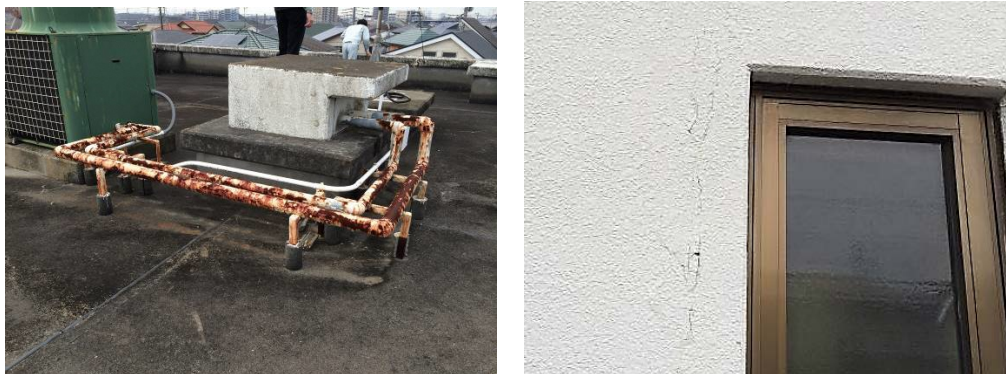
図 5-12 東部支所の劣化状況（左図：屋上、右図：外壁）
