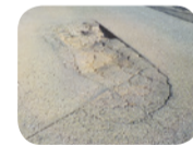
道路の陥没の修復前
