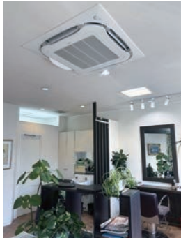
店内に設置された新しい空調設備
