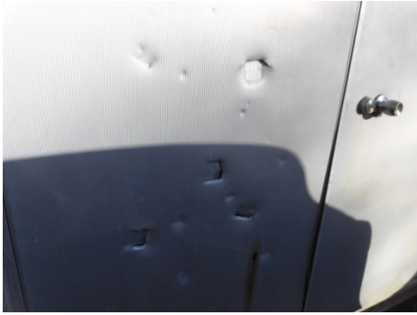
倉庫扉に凹みや穴があいている
