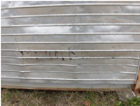
倉庫の表示が消えている
