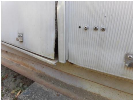
倉庫扉が歪んでいる
