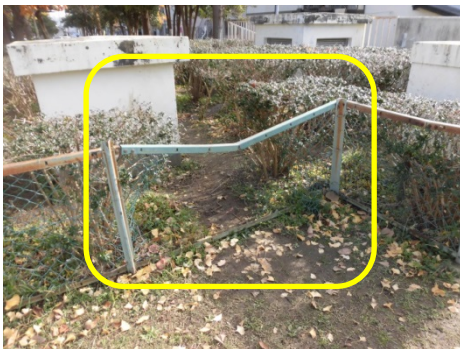
フェンス破損（西馬橋防災倉庫）
