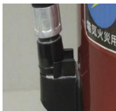
× 消火薬剤の漏れ
