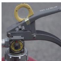
× 表示装置の脱落
