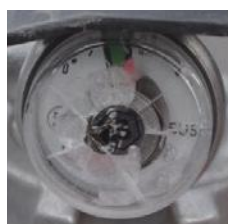
× 指示圧力計の損傷
