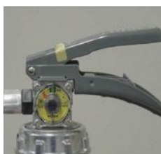
× 安全栓の脱落
