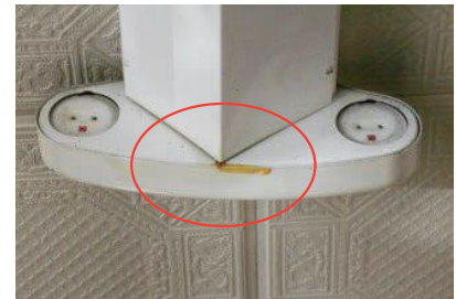
蛍光灯安定器の劣化により蛍光灯機器からPCB油が漏れ出した例
