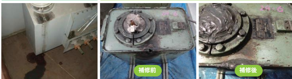
漏洩廃電気機器の例
