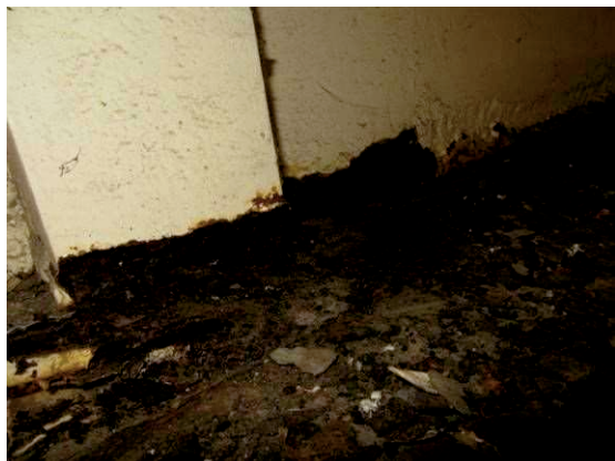
階段桁 腐食,断面欠損:子と清水歩道橋
