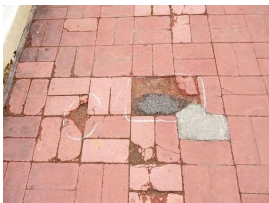
舗装 欠損,ひびわれ:子と清水歩道橋
