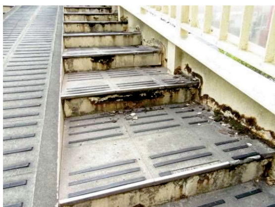
蹴上げ 腐食,防食機能の劣化:子と清水歩道橋
