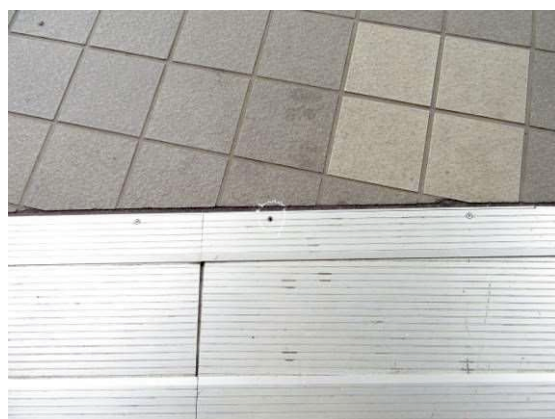
伸縮装置 ネジ脱落:東松戸駅前横断歩道橋
