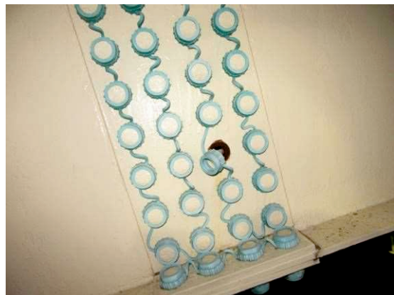
主桁 ボルト脱落(F11T):子と清水歩道橋
