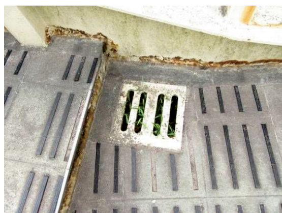
排水受け 土砂詰まり:子と清水歩道橋
