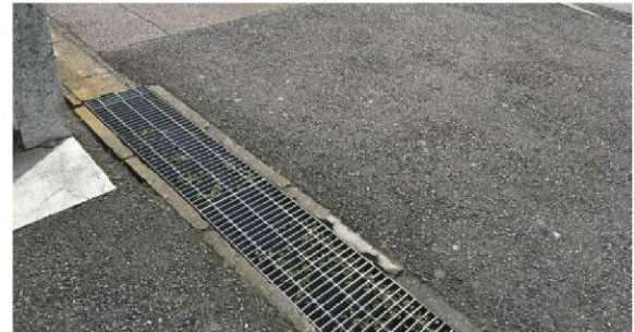
歩道上の粗目グレーチング蓋
